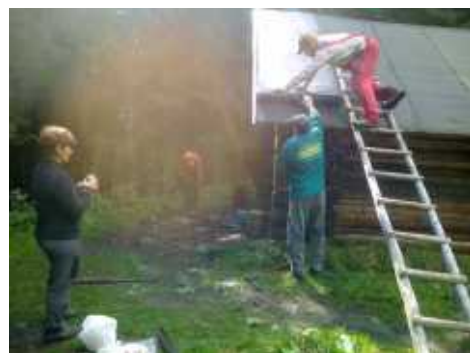
• Nutná oprava strechy...
