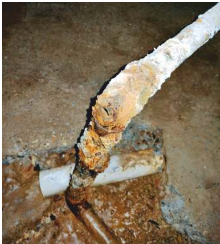
• Poruchu na vodovode sa podarilo odhaliť a nájsť po viac ako 40-tich rokoch
