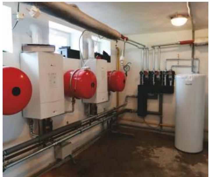
• V plynovej kotolni boli inštalované 3 ks nových kotlov Junkers s príslušenstvom a 300 l zásobník s ohrevom teplej vody
