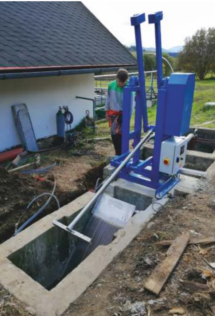
• Samočistiace zariadenie na vtoku do ČOV
